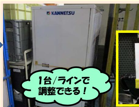
改善後 温調機本体と 遠隔操作盤
